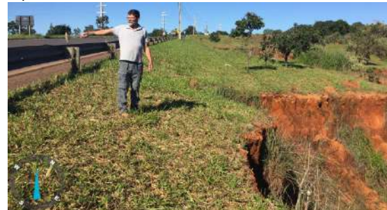
Figura 43 – Voçoroca ao longo da BR-479. Observe a proximidade com a rodovia.
