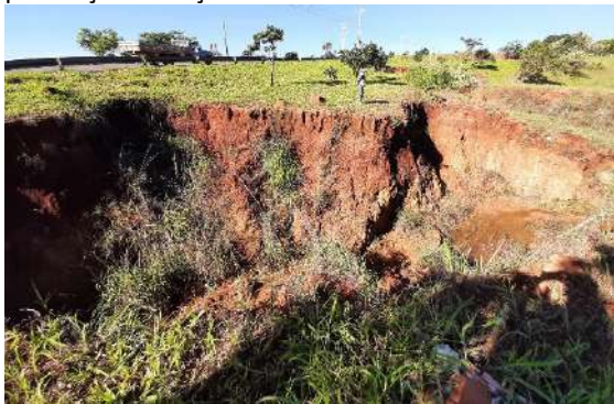
Figura 44 – Voçoroca ao longo da BR-479. Observe presença do lençol freático.
